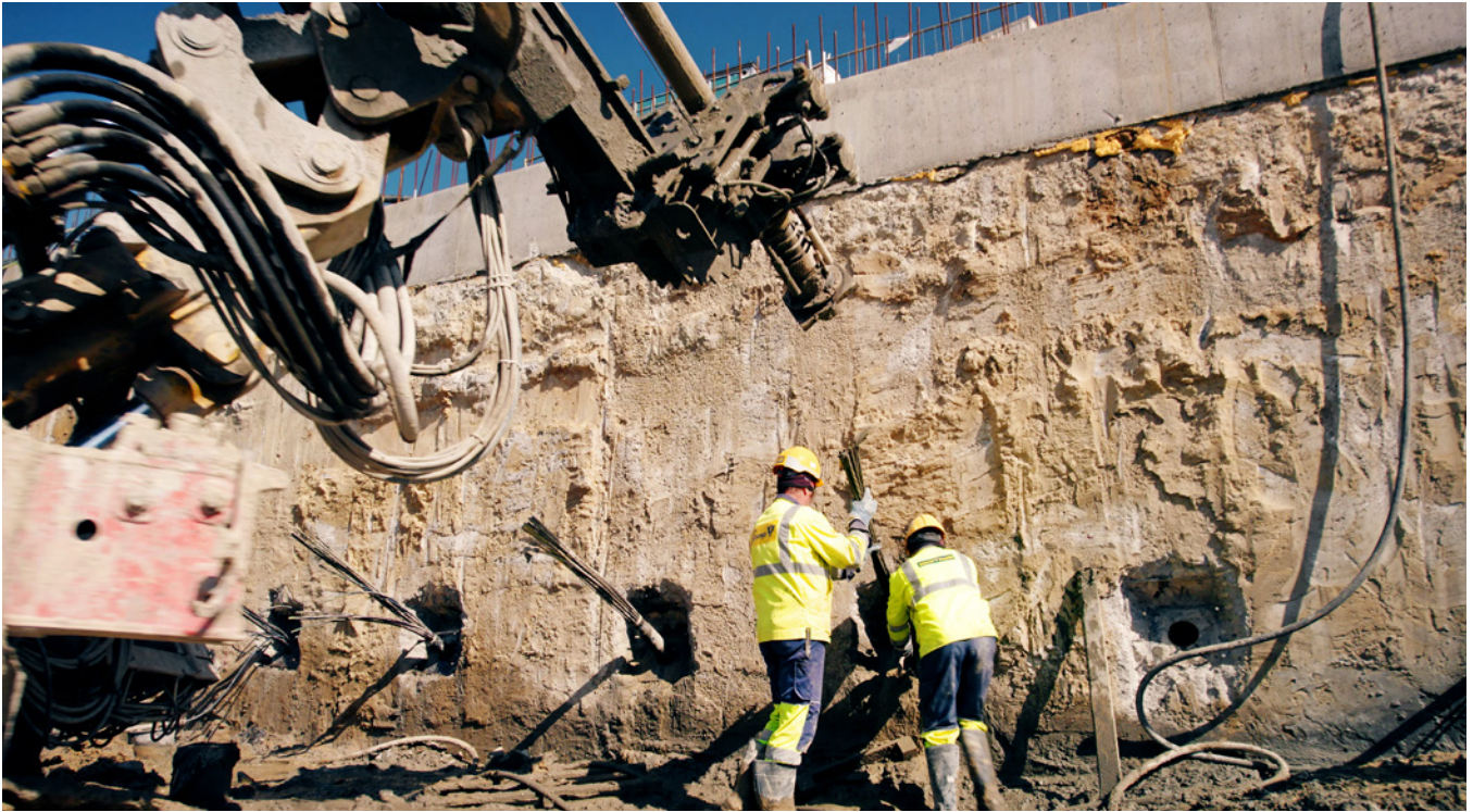
Ryc. 8. Kotwy podwodne dwubulawowe, ul. Szturmowa w Warszawie
